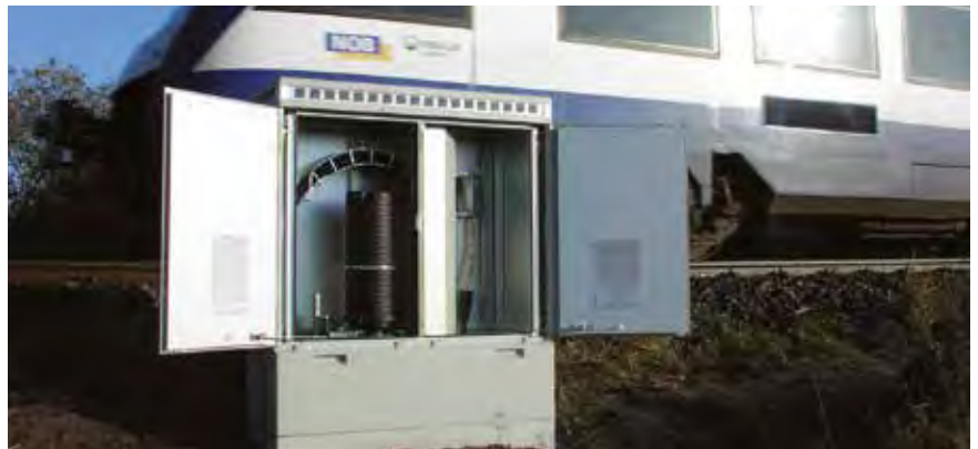
Testsieger RailOptic SFK LWL-Schienenfußkabel der Bayka bei der Deutschen Bahn AG
