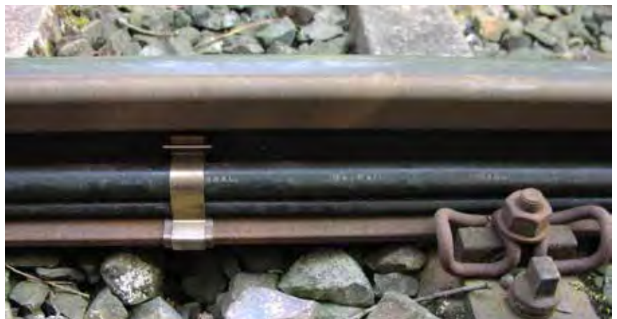
LWL-Schienenfußkabel und Cu-Schienenfußkabel
