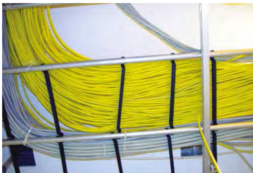
Bayka-HF-Schaltkabel bei der Deutschen Telekom AG
